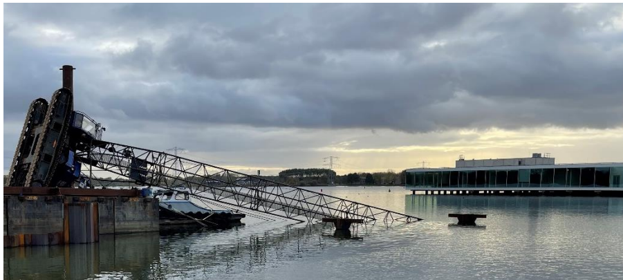
Afbeelding 4 Gekantelde kraan met 2 stelpalen (3 e paal ligt samen met heiblok onder water)
