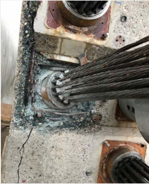
FOTO 1 – GEKLAPTE SPANKOP MET SCHEUR IN BETON
